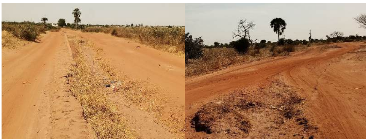
Photo 1&2 : Vue de l'état de la route
