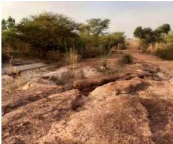
PK0+550 : Forte dégradation de la route
