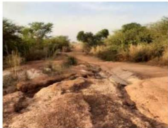
PK0+900 : Route transformée en chenal
