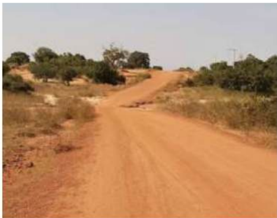
PK 9+200 : Pente du profil en long assez forte
