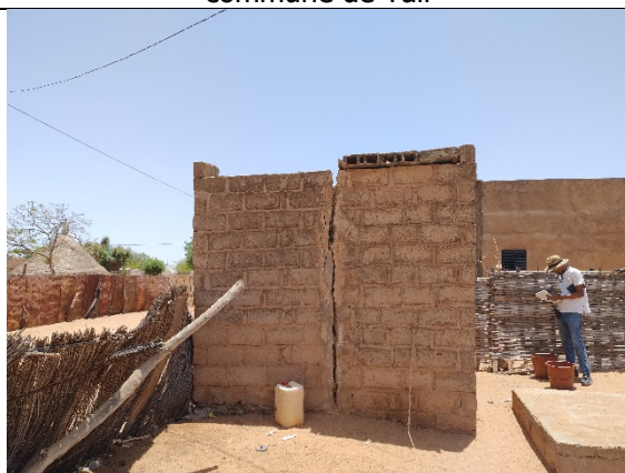
Photo 7 : Vue d'une toilette en dur affectée et d'une clôture en palissade au sein d'une structure d'habitation dans l'emprise de la route nationale au niveau de la commune de Dealy
