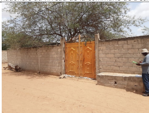
Photo 9 : Vue d'un mur de clôture et d'un banc affectés au sein d'une structure d'habitation dans l'emprise de la route nationale au niveau de la commune de Thiel
