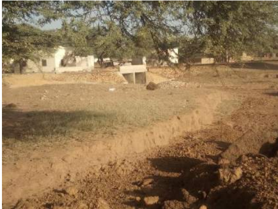
Pont affaissé l'hivernage 2019
