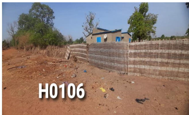
Photo 2: Concessions dont la clôture est impactée sur la section Sily-Ségou
